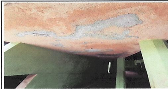
Foto 5: TERRAZA CON FILTRACIONES
