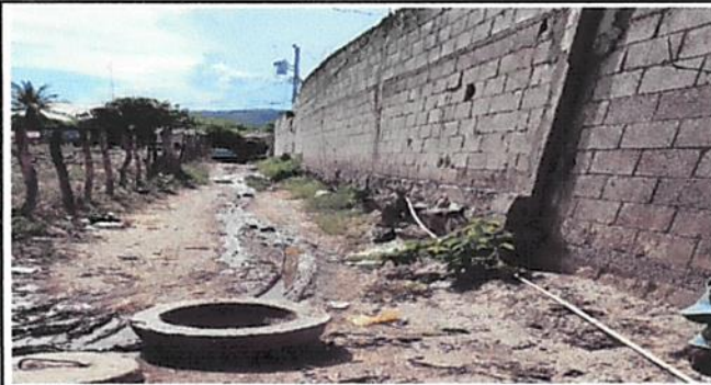
Foto 1: MURO PERIMETRAL EN MAL ESTADO
