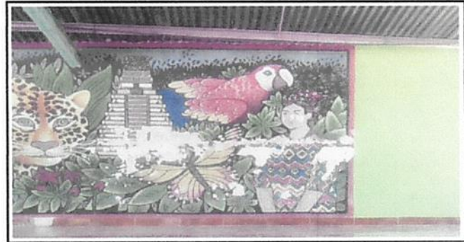
FOTO 6: REPELLO EN MAL ESTADO
